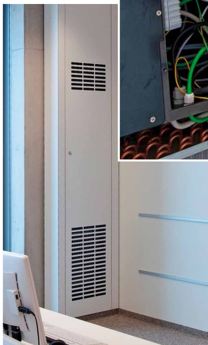
Automation der Trox Schoolair-Lüftungsgeräte über integrierte, frei programmierbare LOYTEC L-IOB I/O Controller
