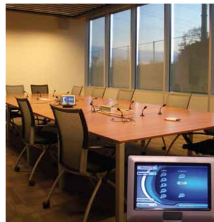
Raumautomation mit AV-Technik
