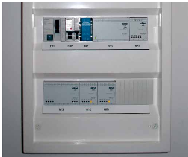
Modulares ELKA LON I/O-System im Verteiler des Hotelzimmers
