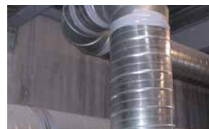
Bild 4: Lüftungsgeräte mit Wärmerückgewinnung
